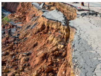
• un glissement de terrain
